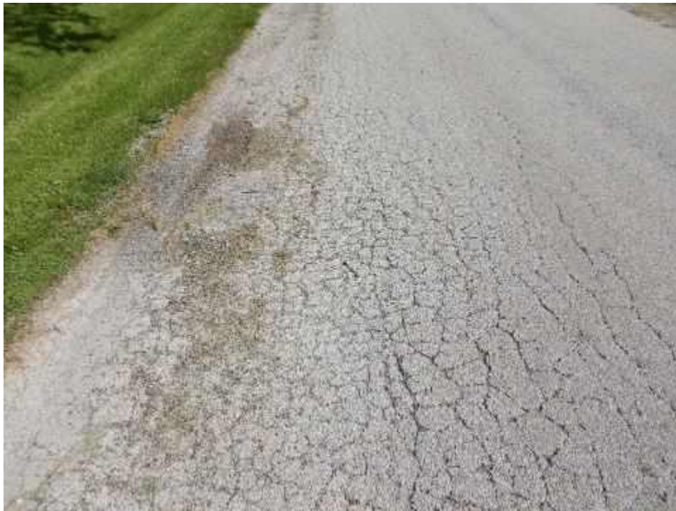
WRIGHS-S18-Alligator Cracking-(Sample Unit No. 01)
