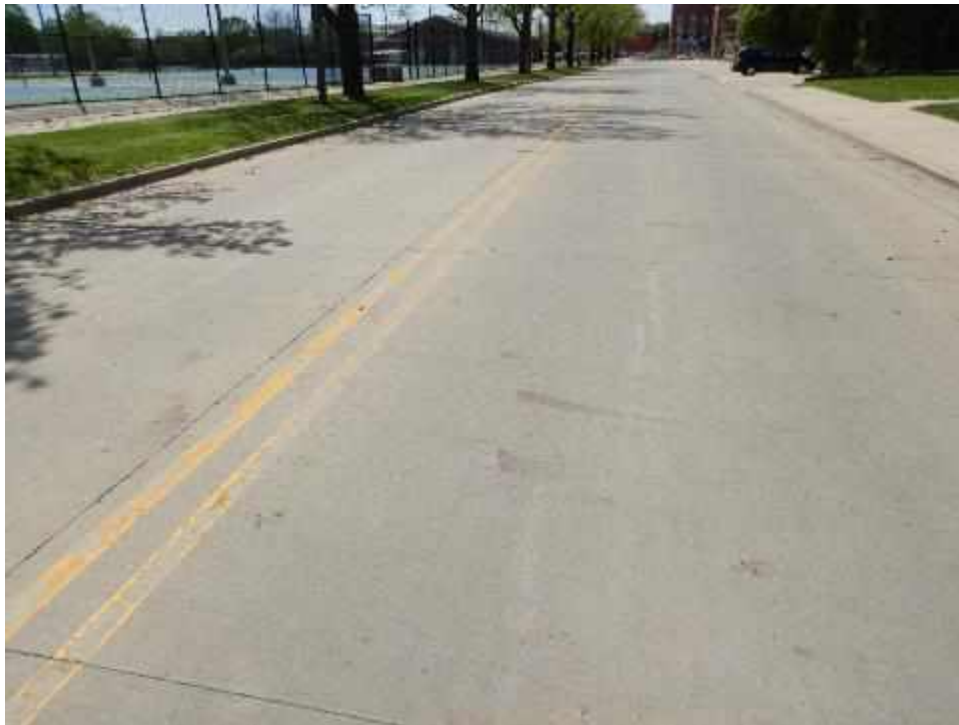
GREGYD-E00-Overview-(Sample Unit No. 01)
