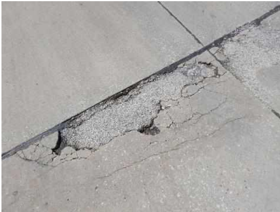
OAKS-S10A-Joint Spalling-(Sample Unit No. 01)
