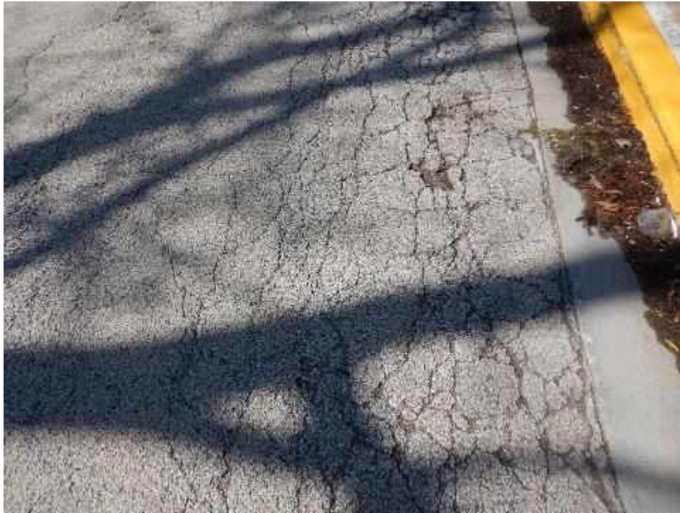
EUCLDS-S12-Alligator Cracking-(Sample Unit No. 02)
