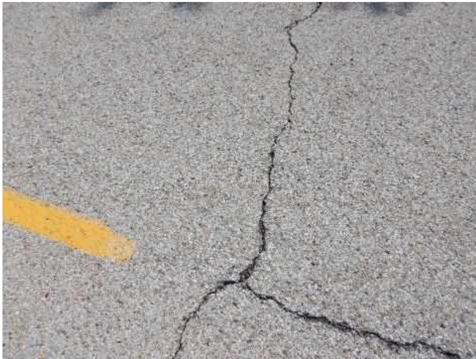
OAKS-S20A-L&T Cracking-(Sample Unit No. 01)
