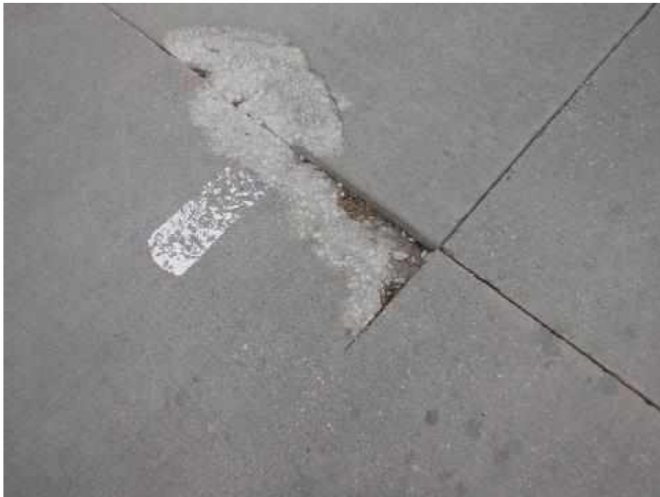
GREGYD-UW12B-Corner Spalling-(Sample Unit No. 01)
