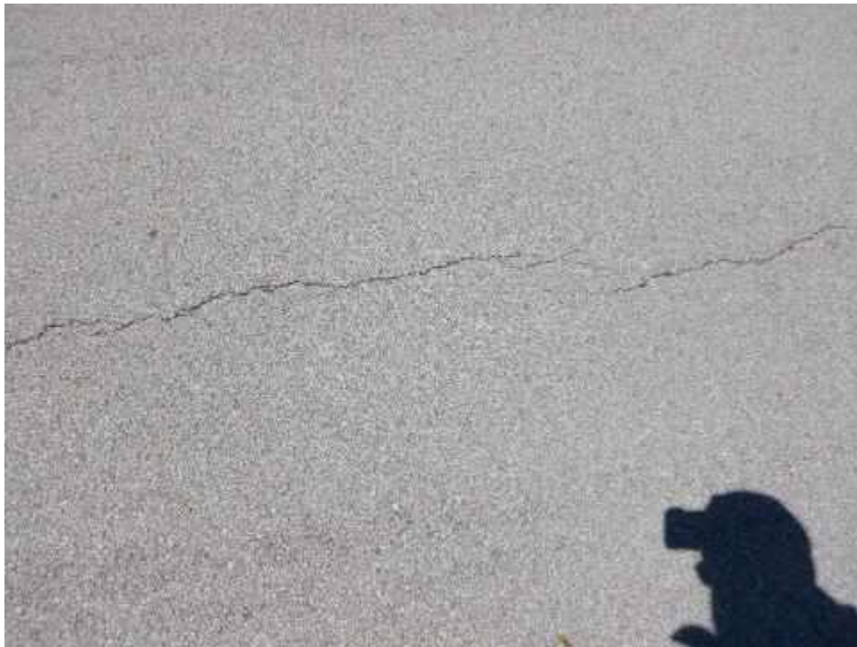
FOURTS-S15A-L&T Cracking-(Sample Unit No. 01)
