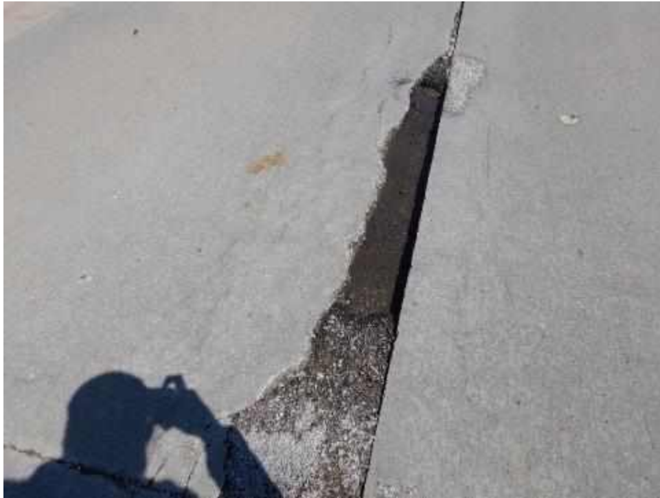
OAKS-S16-Durability Cracking-(Sample Unit No. 02)
