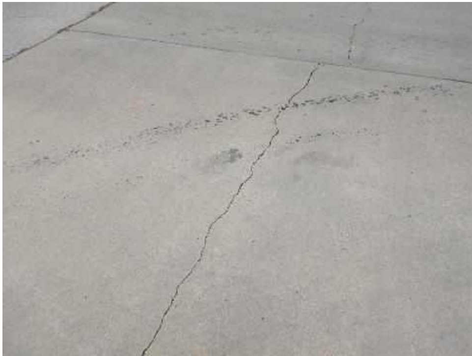
FOURTS-S15B-LTD Cracking-(Sample Unit No. 01)
