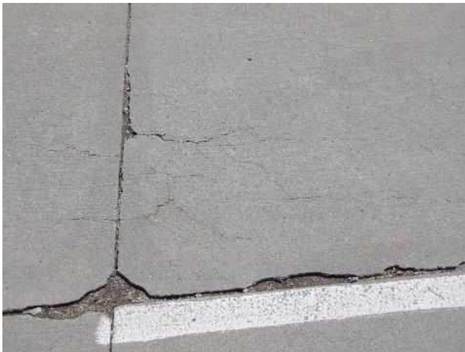
OAKS-S16-Durability Cracking-(Sample Unit No. 01)
