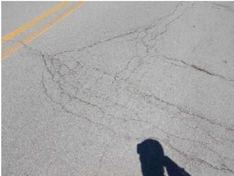
FOURTS-S12-Alligator Cracking-(Sample Unit No. 003)
