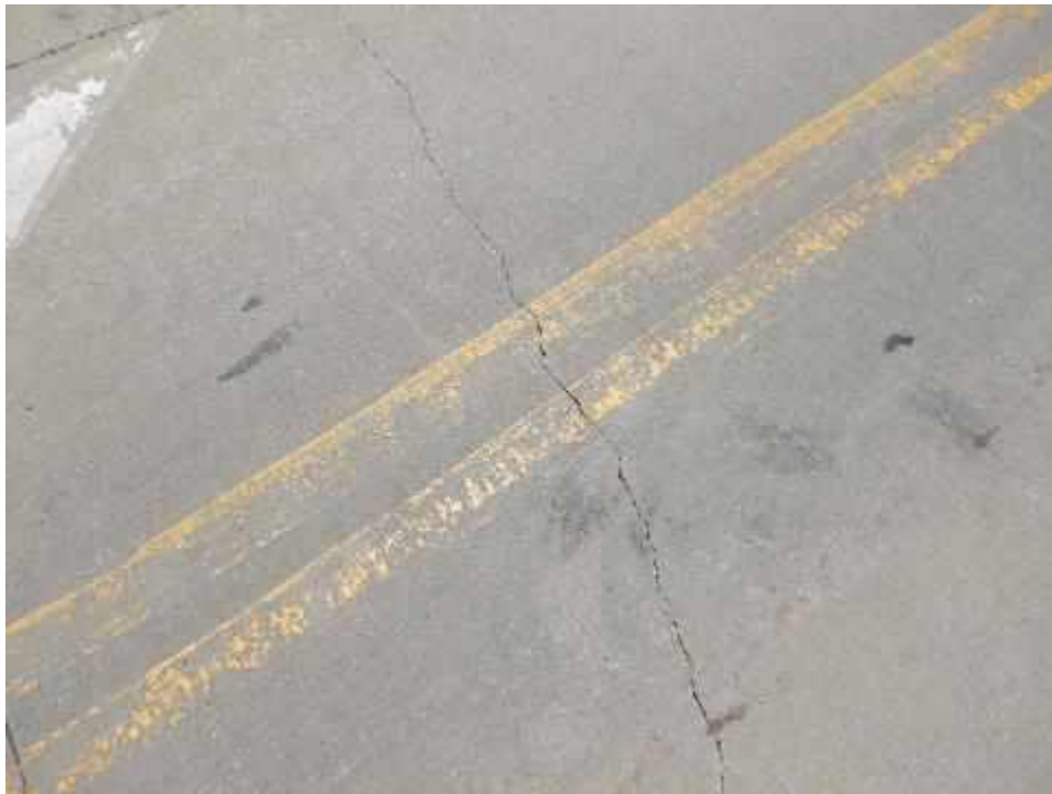
GREGYD-E04-LTD Cracking-(Sample Unit No. 01)
