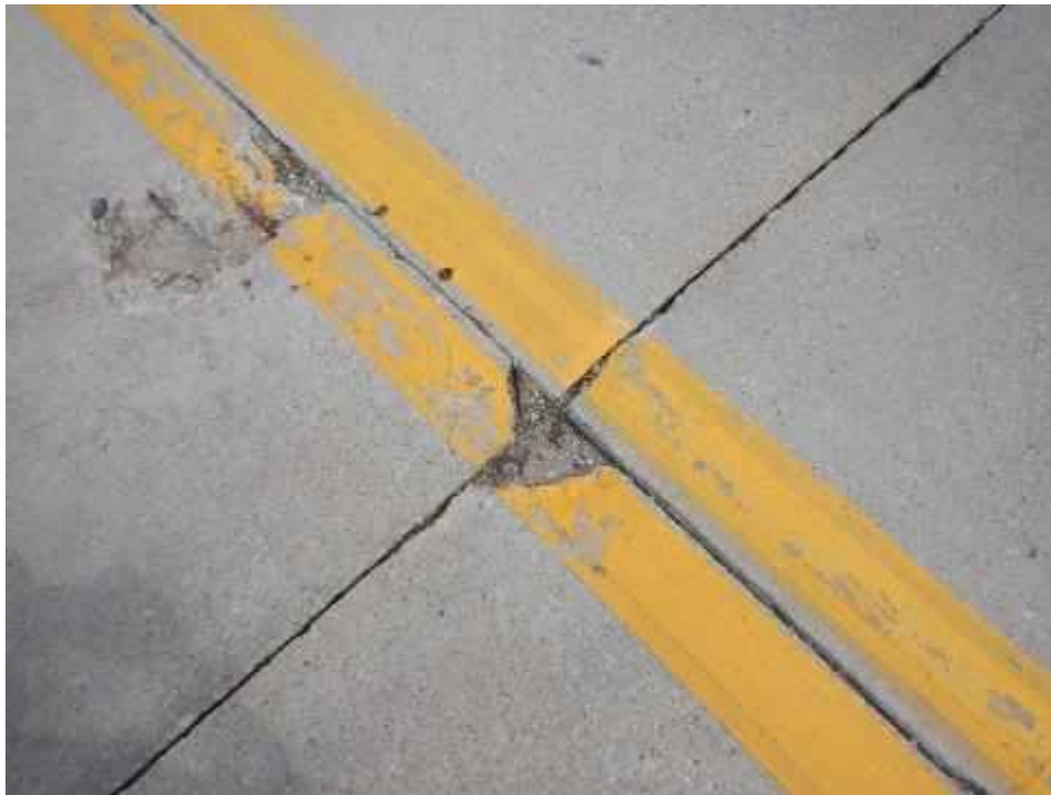
GREGYD-UW12D-Corner Spalling-(Sample Unit No. 01)
