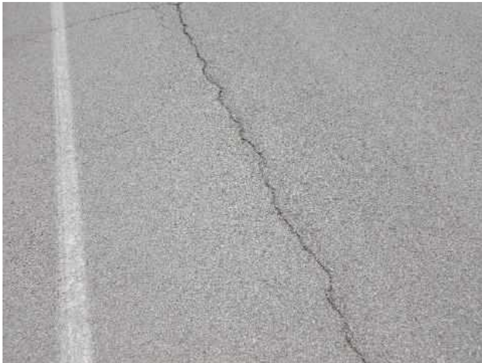
FOURTS-S11-L&T Cracking-(Sample Unit No. 01)
