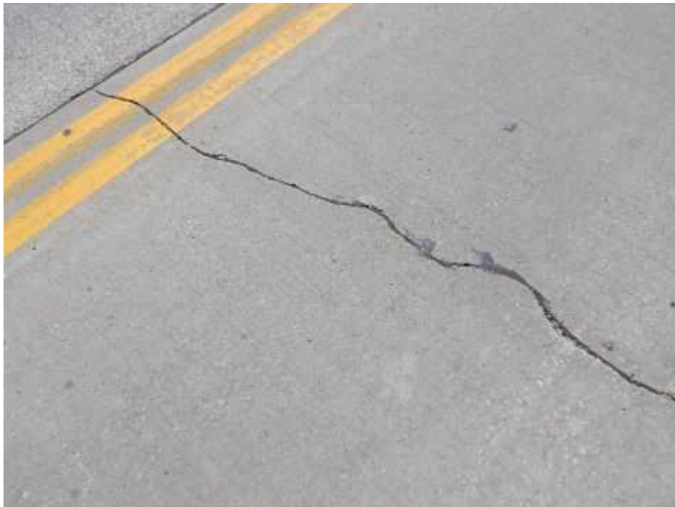
GREGYD-E01BN-LTD Cracking-(Sample Unit No. 01)
