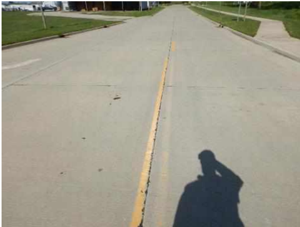
HAZELWDD-E01B-Overview-(Sample Unit No. 01)
