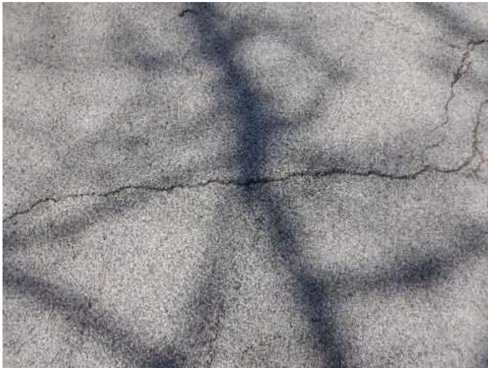
EUCLDS-S12-L&T Cracking-(Sample Unit No. 01)
