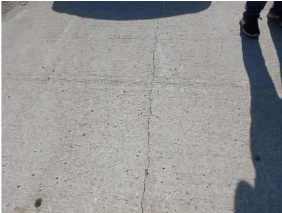
HAZELWDD-E01C-LTD Cracking-(Sample Unit No. 01)
