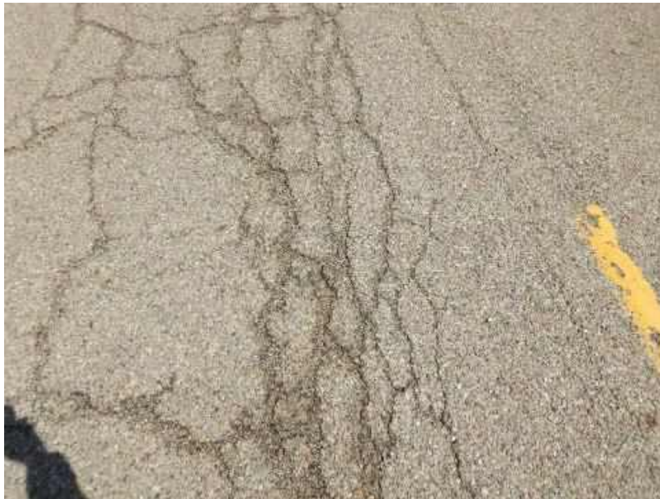
OAKS-S18A-Alligator Cracking-(Sample Unit No. 02)
