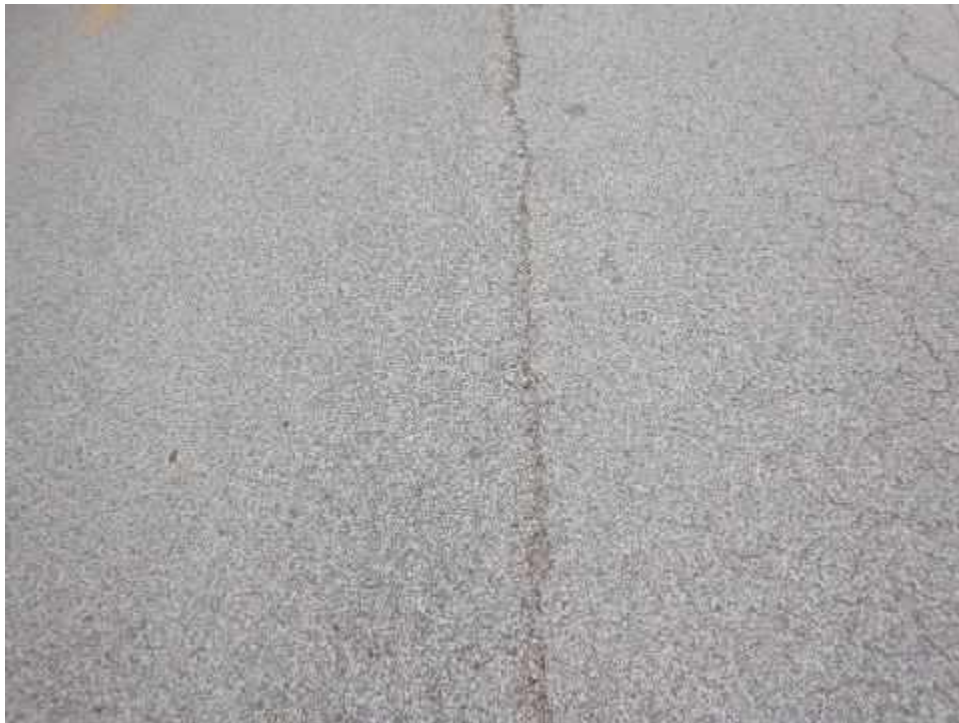
PENSYA-UW12B-L&T Cracking-(Sample Unit No. 01)
