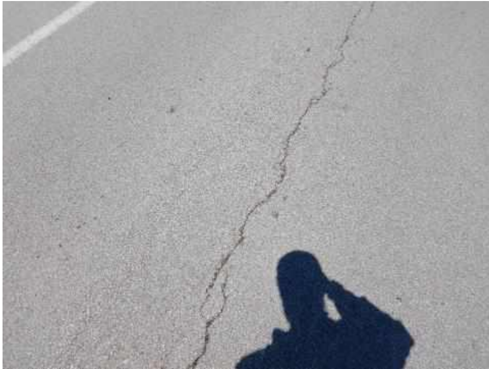
FOURTS-S14-L&T Cracking-(Sample Unit No. 01)
