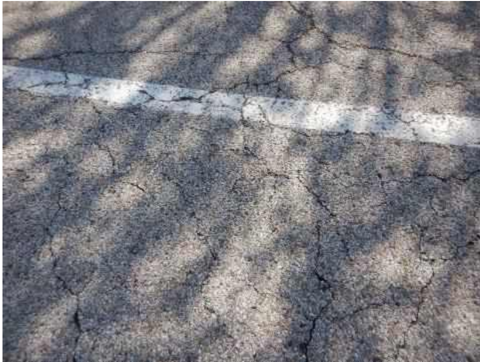
OAKS-S20A-Alligator Cracking-(Sample Unit No. 01)
