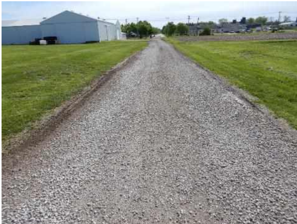
HAZELWDD-UW12B-Overview-(Sample Unit No. 01)
