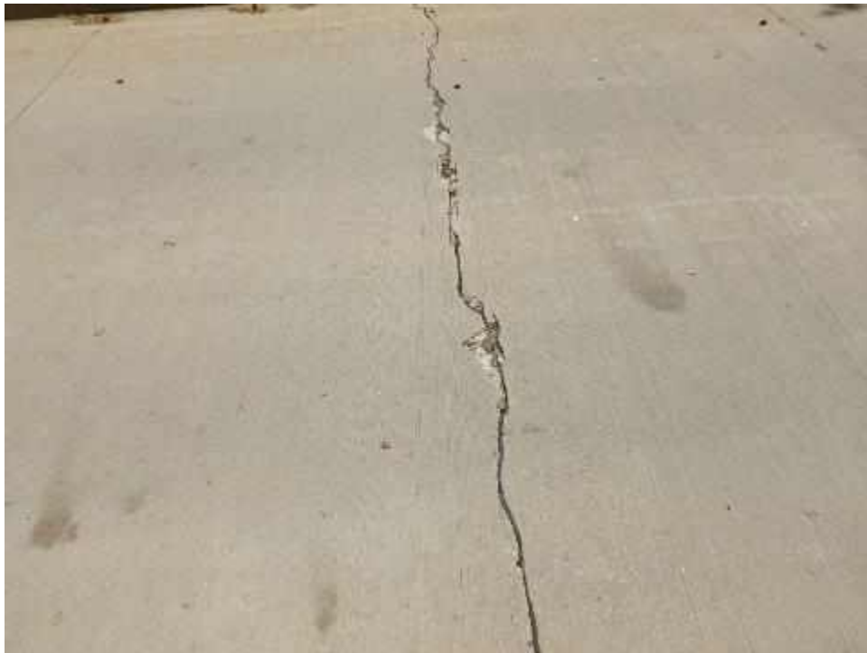
GREGYD-E00-LTD Cracking-(Sample Unit No. 01)
