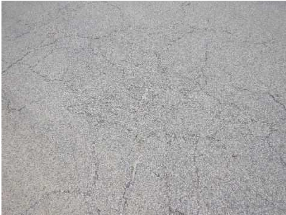
GREGYD-UW11-Alligator Cracking-(Sample Unit No. 01)
