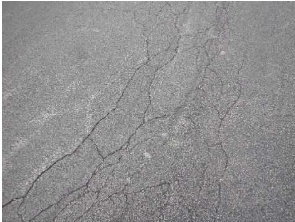
GREGYD-UW10-Alligator Cracking-(Sample Unit No. 01)
