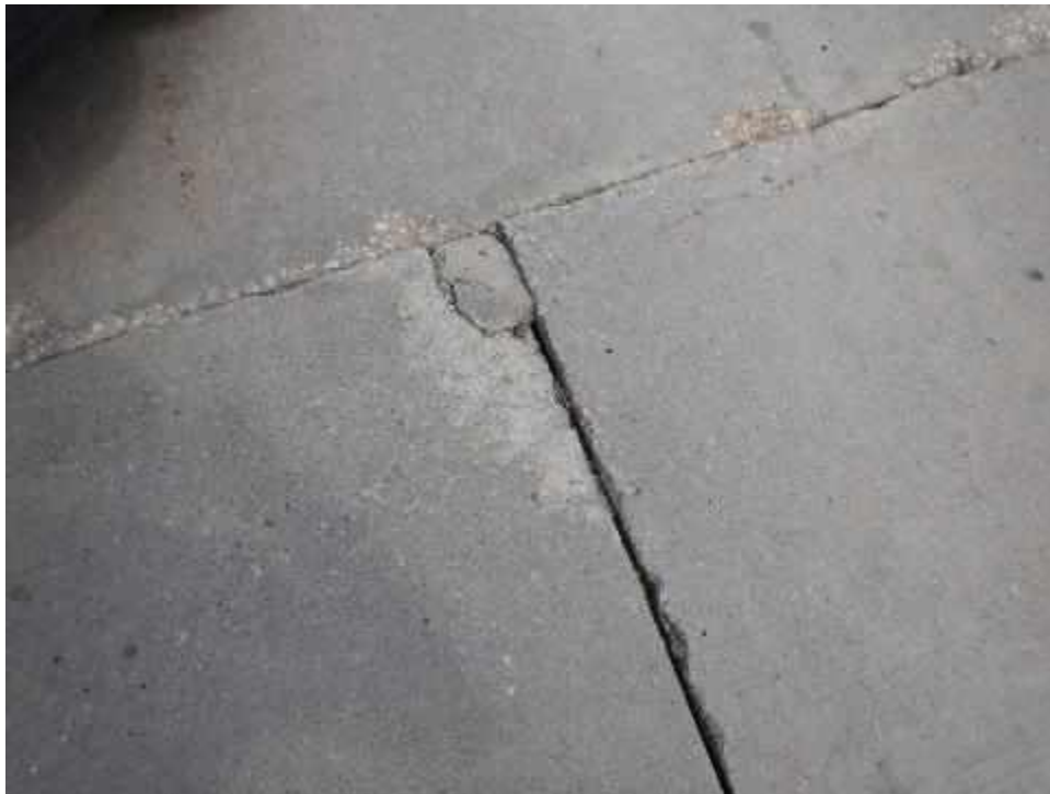
GREGYD-UW12C-Corner Spalling-(Sample Unit No. 01)
