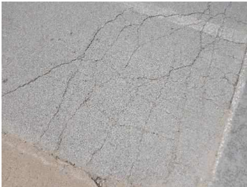
FOURTS-S11-Alligator Cracking-(Sample Unit No. 01)
