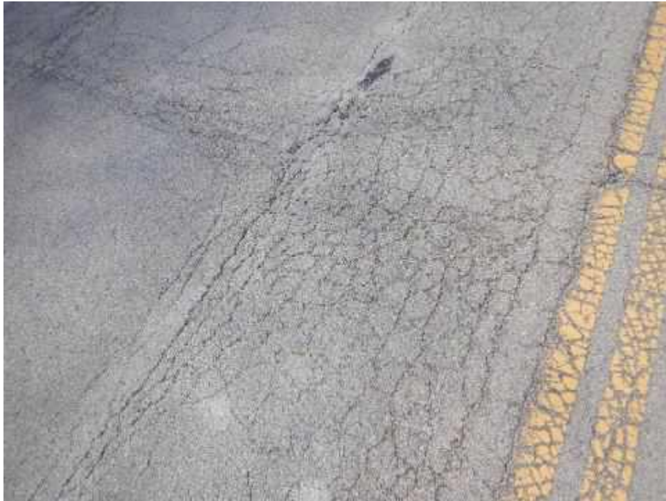
GOODWINA-US08-Alligator Cracking-(Sample Unit No. 01)
