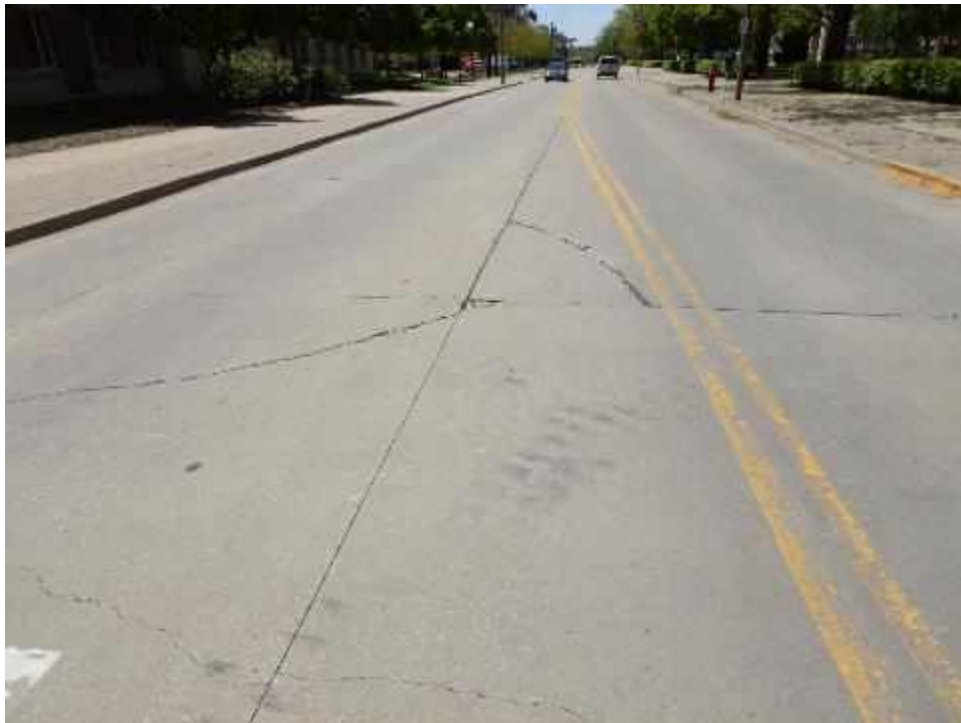
GREGYD-E04-Overview-(Sample Unit No. 01)
