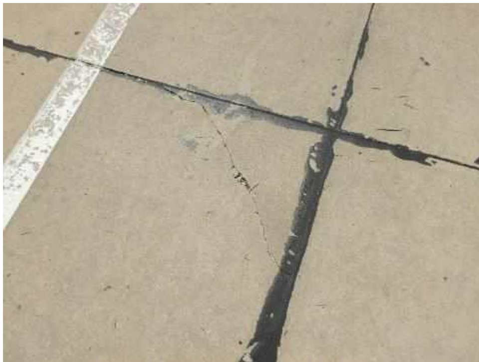
GREGYD-E02B-Corner Spalling-(Sample Unit No. 01)
