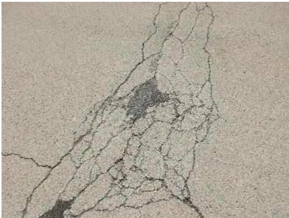
GOODWINA-US12-Alligator Cracking-(Sample Unit No. 01)
