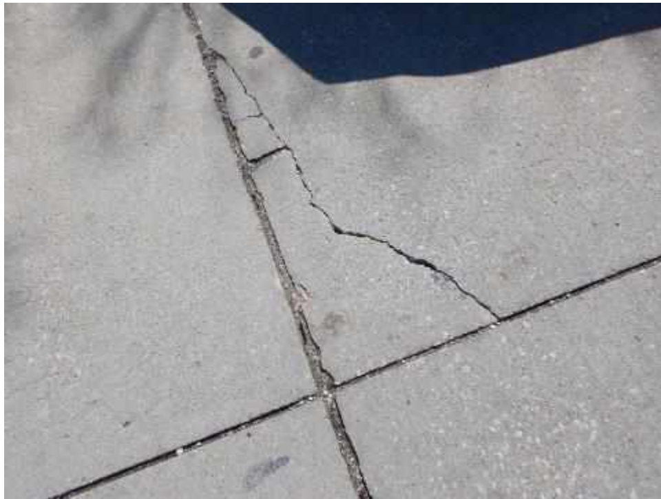
OAKS-S12-Corner Spalling-(Sample Unit No. 01)
