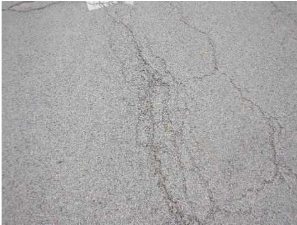
PENSYA-UW11B-Alligator Cracking-(Sample Unit No. 01)
