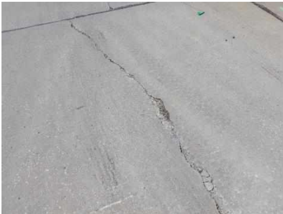
OAKS-S10A-LTD Cracking-(Sample Unit No. 01)
