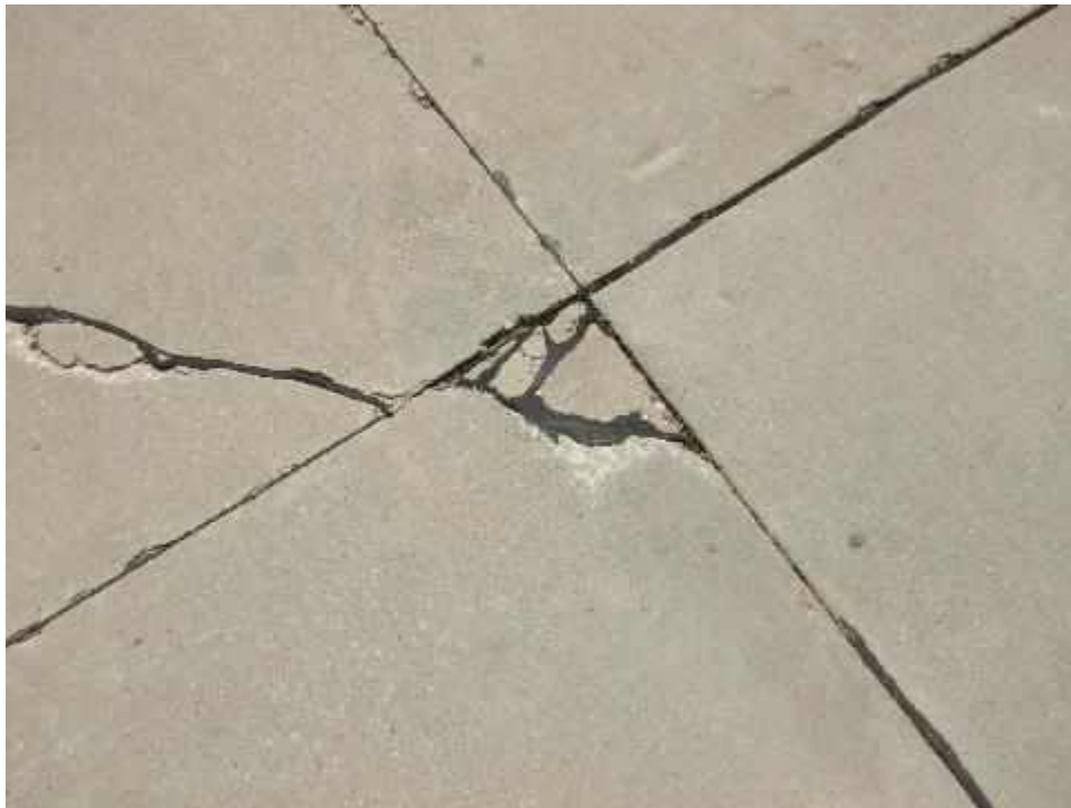
GREGYD-E04-Corner Spalling-(Sample Unit No. 01)
