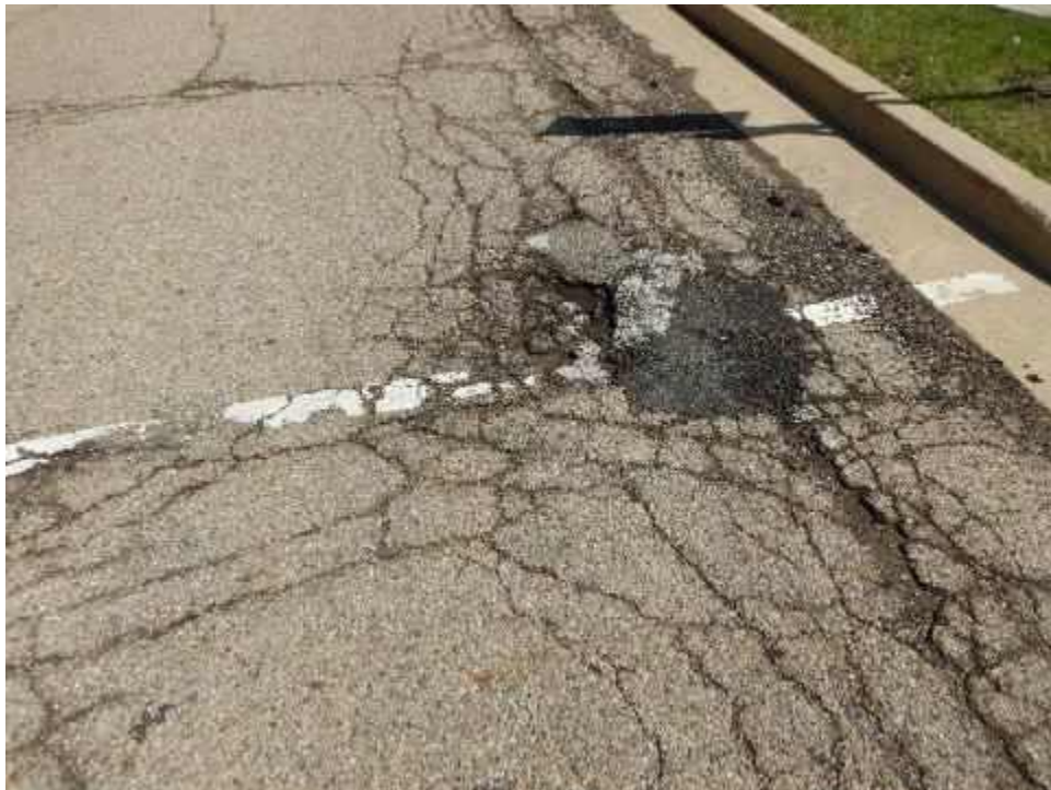
OAKS-S18A-Alligator Cracking-(Sample Unit No. 01)
