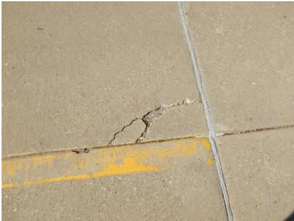
PEABYD-E04B-Corner Spalling-(Sample Unit No. 01)
