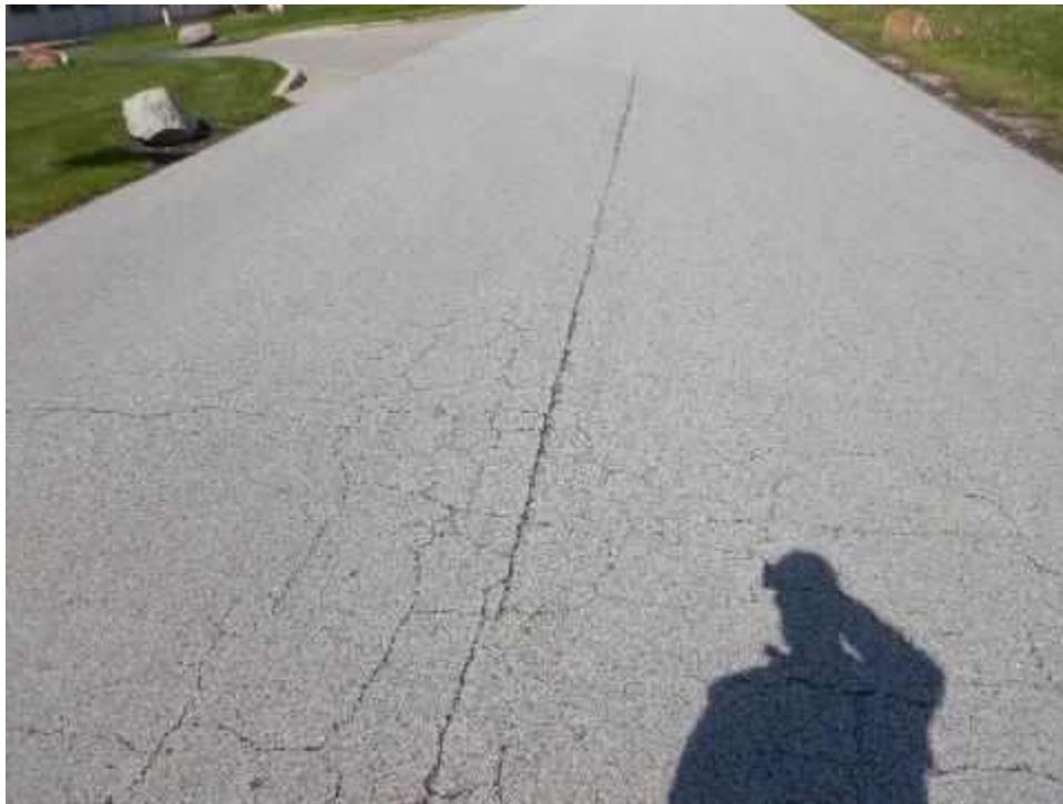
HAZELWDD-E00B-Overview-(Sample Unit No. 01)
