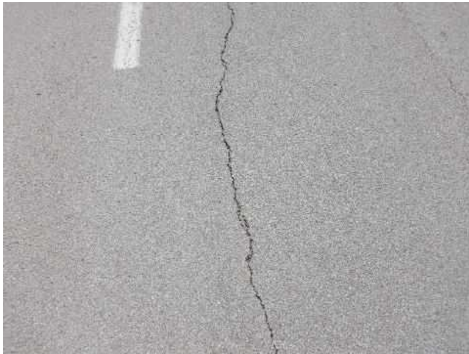
FOURTS-S12-L&T Cracking-(Sample Unit No. 01)
