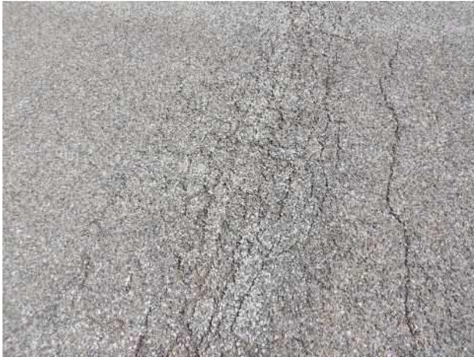
PEABYD-E06B-Alligator Cracking-(Sample Unit No. 01)
