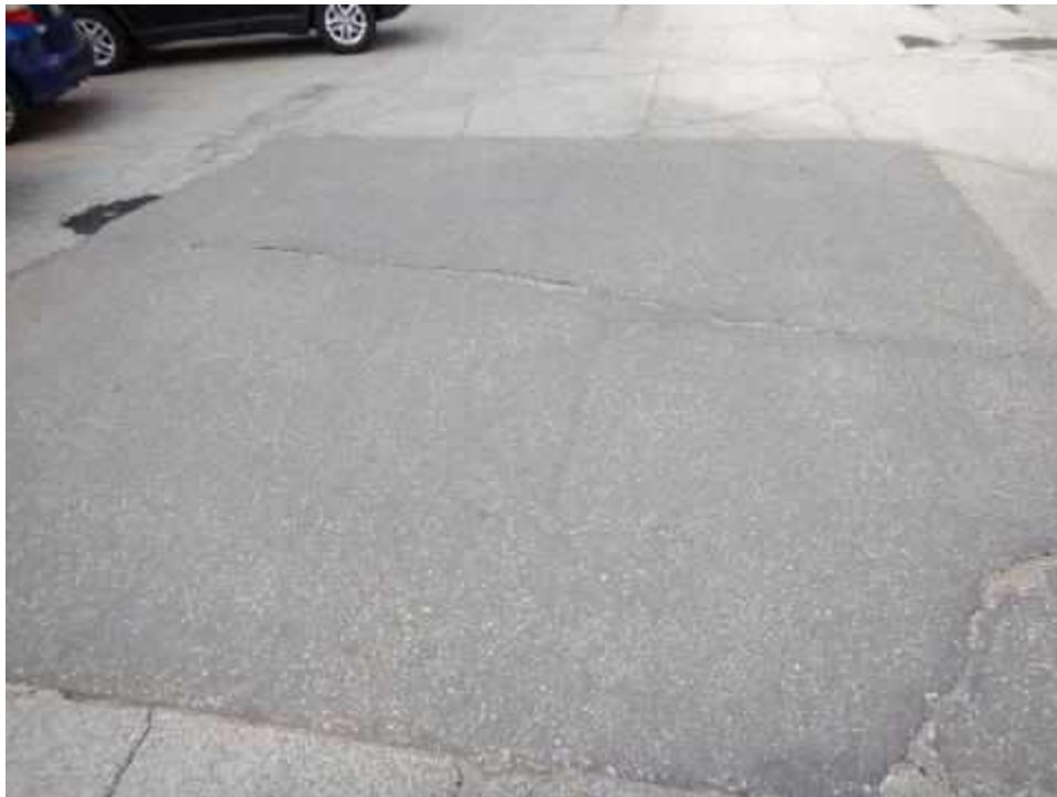
GRGRYST-US05-Patching-(Sample Unit No. 01)
