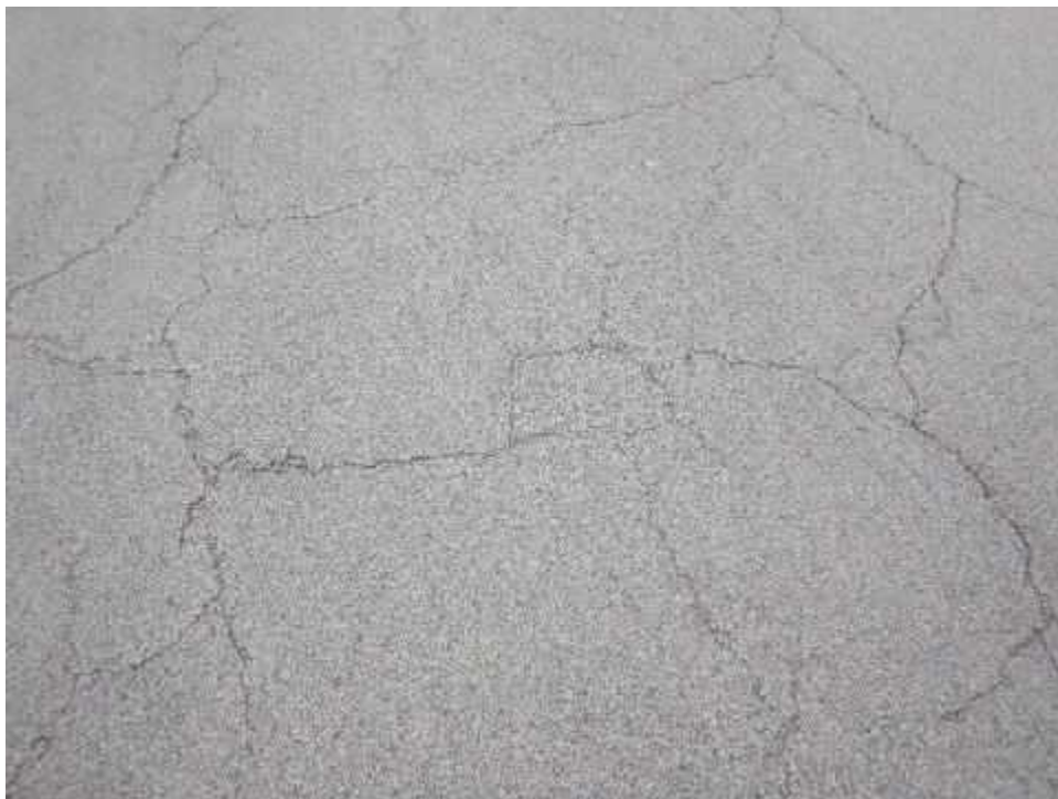
PENSYA-UW11B-Block Cracking-(Sample Unit No. 01)
