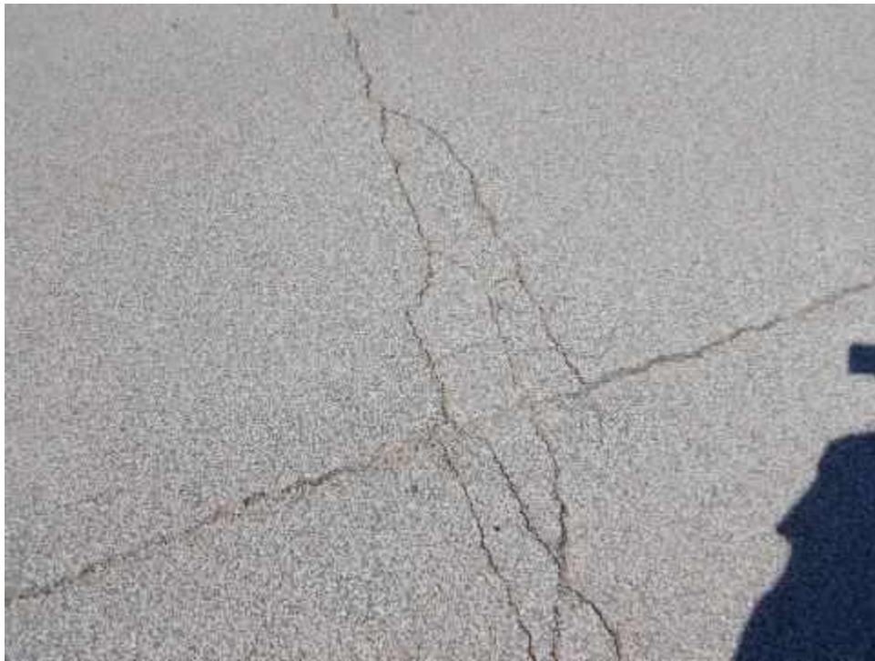
PEABYD-E03-Alligator Cracking-(Sample Unit No. 01)
