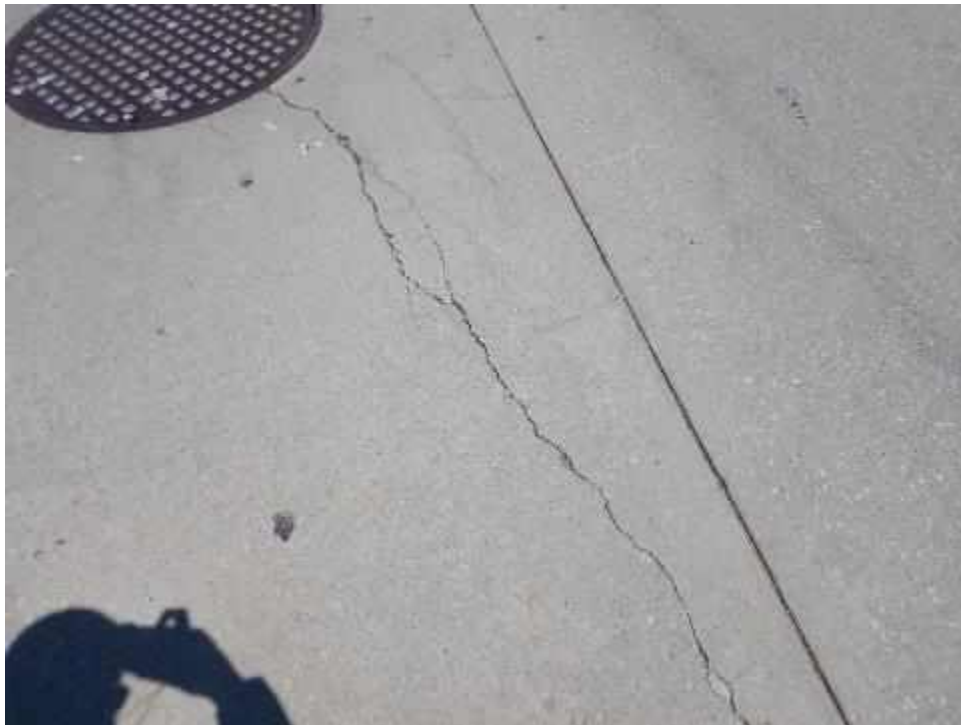
OAKS-S12-LTD Cracking-(Sample Unit No. 01)
