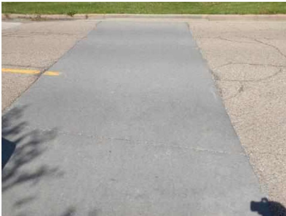
OAKS-S18A-Patching-(Sample Unit No. 02)
