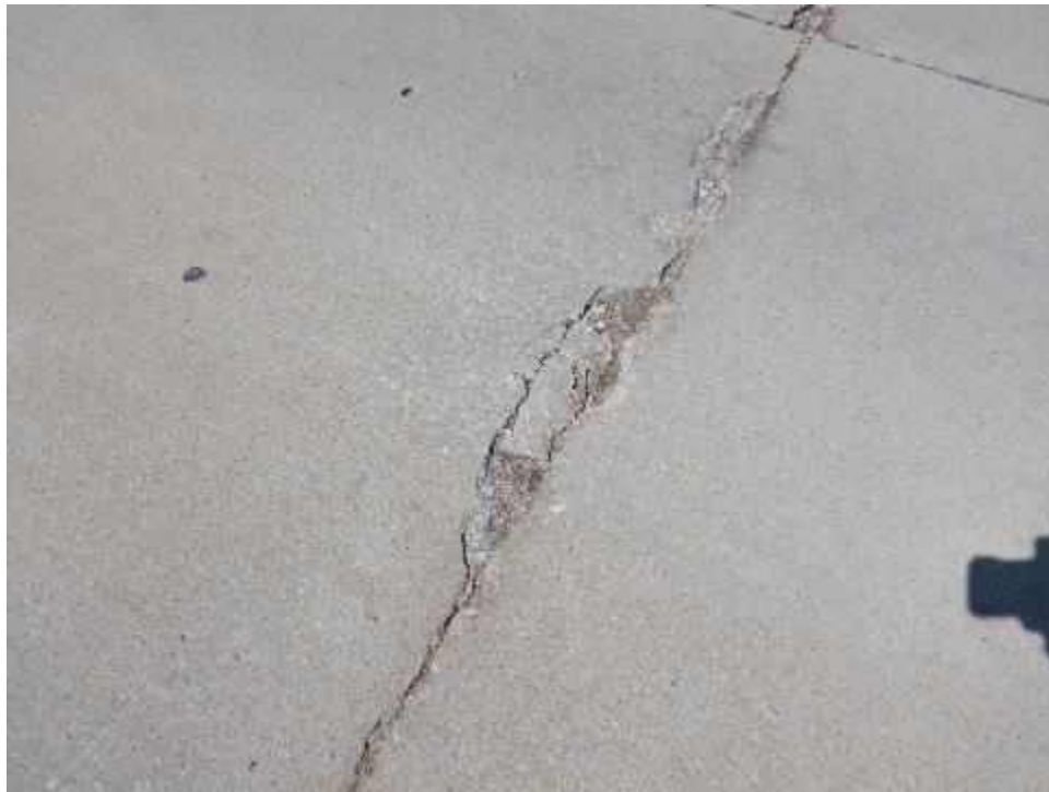
OAKS-S16-Joint Spalling-(Sample Unit No. 01)
