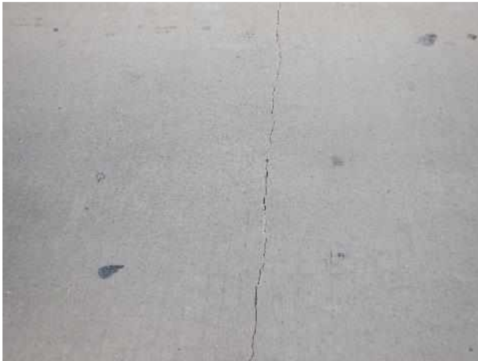
GREGYD-UW12C-LTD Cracking-(Sample Unit No. 01)
