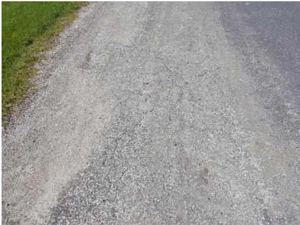
GOODWINA-US19-Alligator Cracking-(Sample Unit No. 01)
