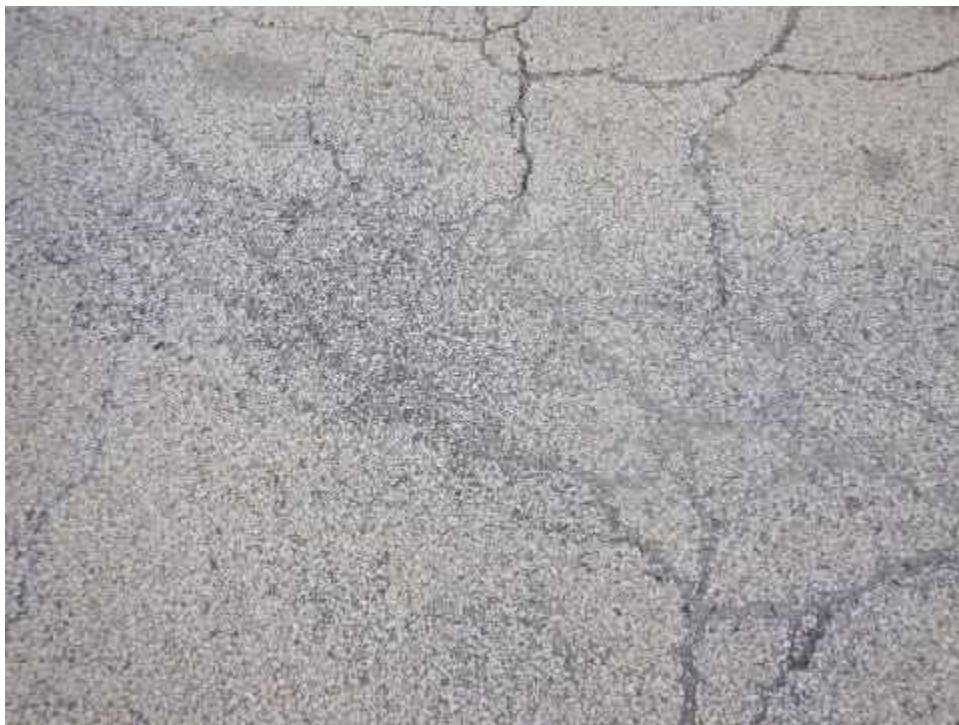
PENSYA-UW12A-Alligator Cracking-(Sample Unit No. 01)
