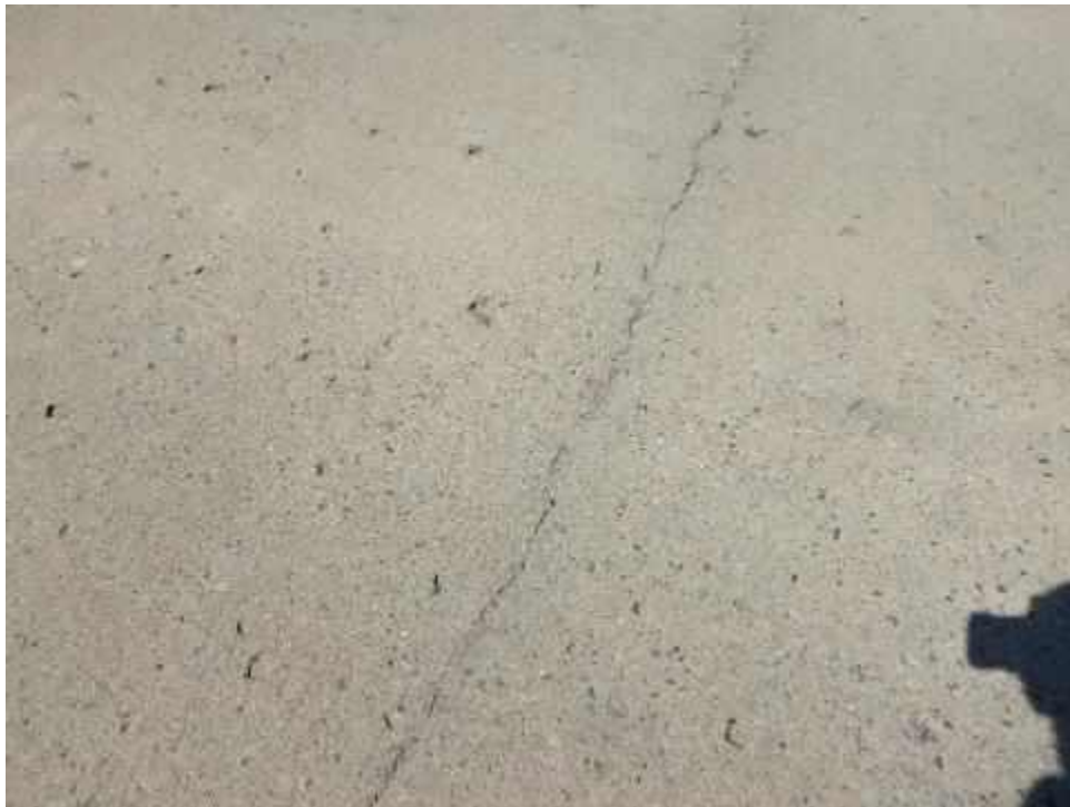
OAKS-S13-LTD Cracking-(Sample Unit No. 01)
