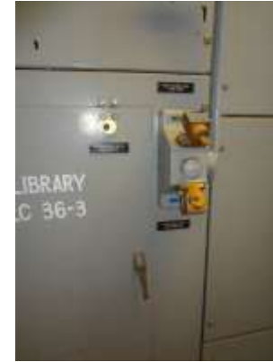
Med voltage switch
